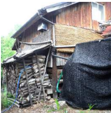
↑ヨシズ取替え完了。／370ℓ貯水タンクを据え付け直し、屋根三面から取水している雨樋も整備し、タンクに接続と遮光ネットで覆う。
